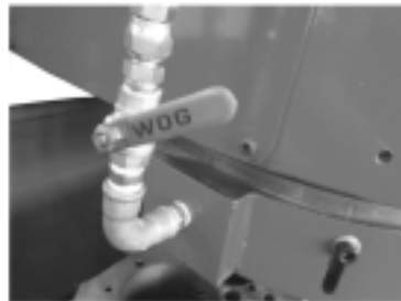
Válvula do sistema de refrigeração
