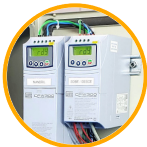
Inversor de frequência da Weg
